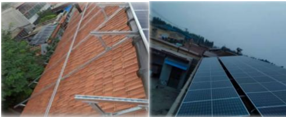
斜屋面户用分布式光伏系统照片
